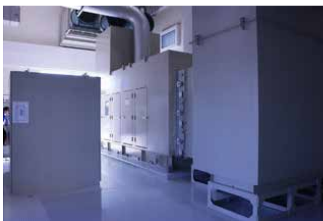
自家発電設備（神野浄水場）
