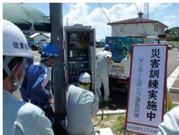
マンホールポンプ運転訓練の様子
