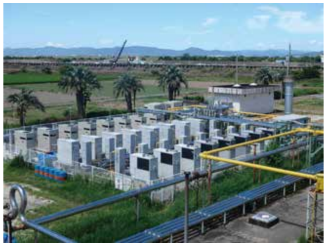
消化ガス発電設備
