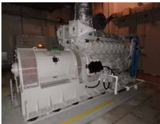
自家発電設備（下水浄化センター）
