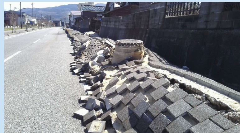
(マンホールと管路の浮上)
