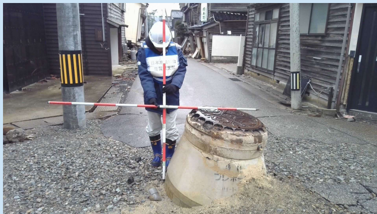
(マンホールの浮上)
