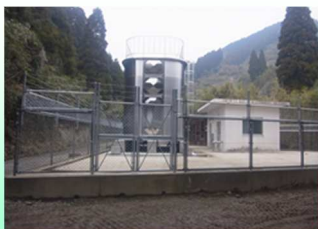
松梅北部水道施設浄水池
