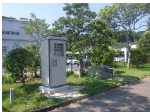
工業用水道取水施設（第3井戸）
