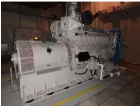
自家発電設備（下水浄化センター）
