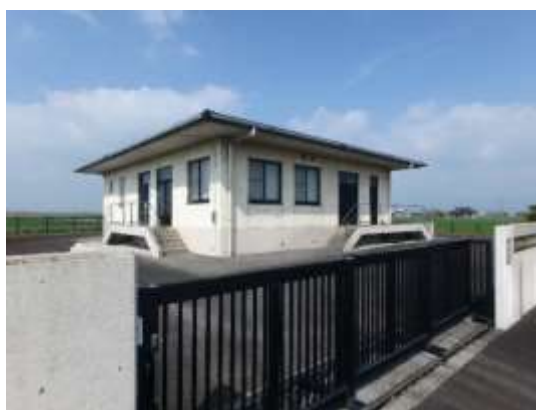
江戸地区農業集落排水施設
