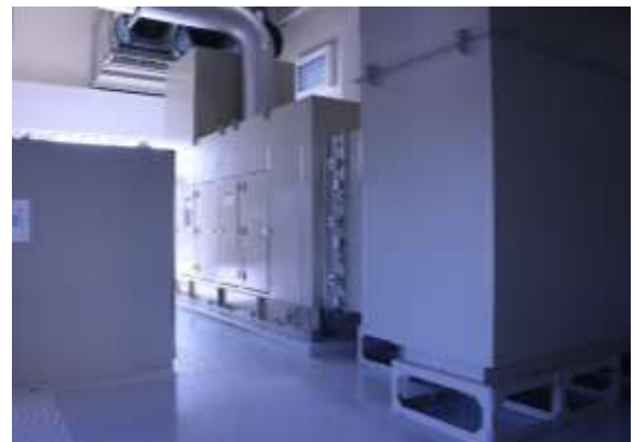
自家発電設備（神野浄水場）
