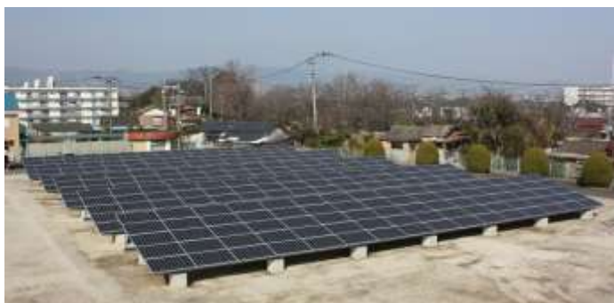
太陽光発電（神野第2浄水場）
