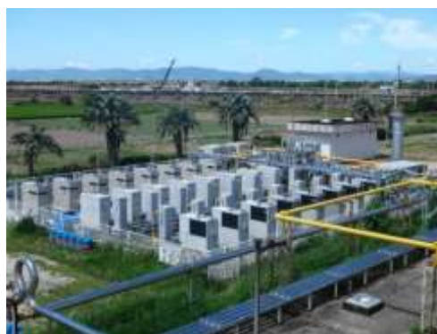
消化ガス発電設備
