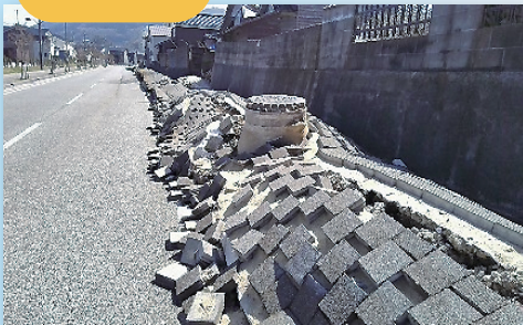
(マンホールと管路の浮上)
