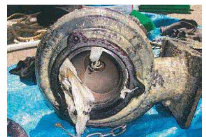
ポンプに布類が詰まった状況
