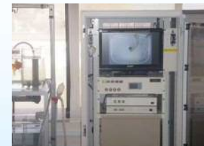
自動毒物監視装置
